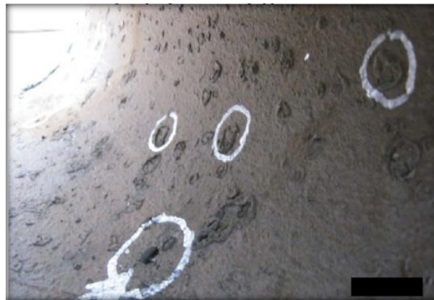
Figura 1.8. Picaduras presentes en ductos de gas natural.
