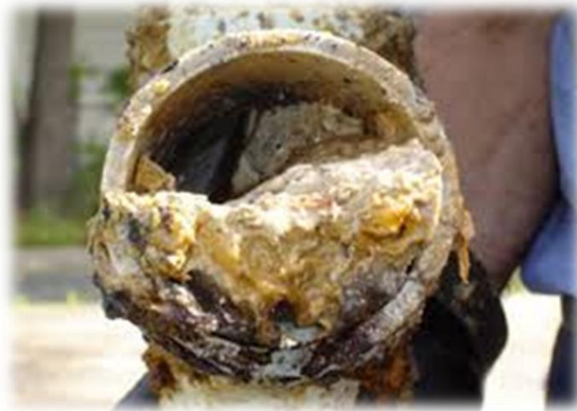
Fig. 2.2 Obstrucción de una tubería por efecto de grasas y aceites.
