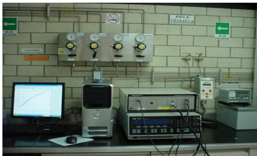
Figura 2.7 Instalaciones para el suministro, dosificación y control de gases: Tuberías, manómetros, flujómetro y campana extractora
