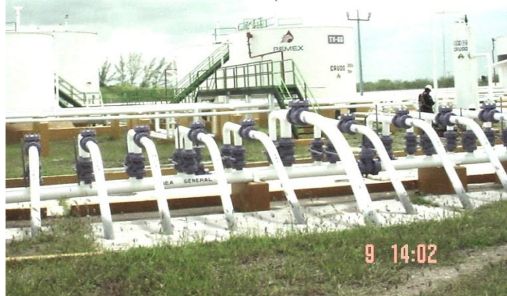
Figura 1.1 Tuberías que transportan la mezcla: Gas- Crudo- Agua a los tanques separadores
