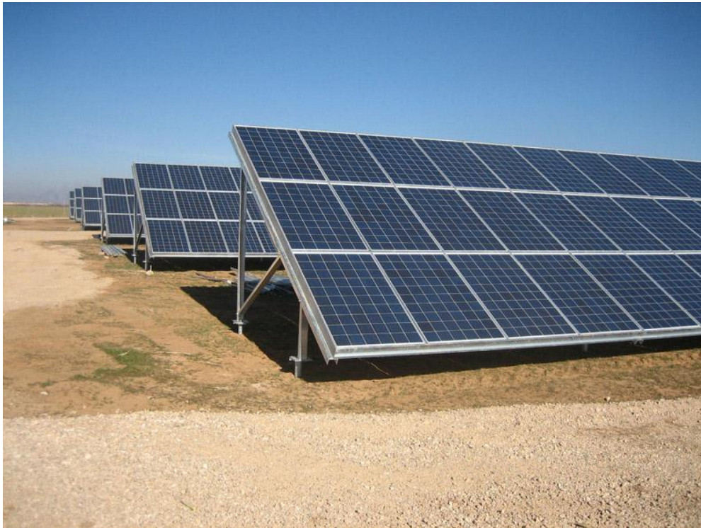
Fig.-1.1 Parque fotovoltaico
