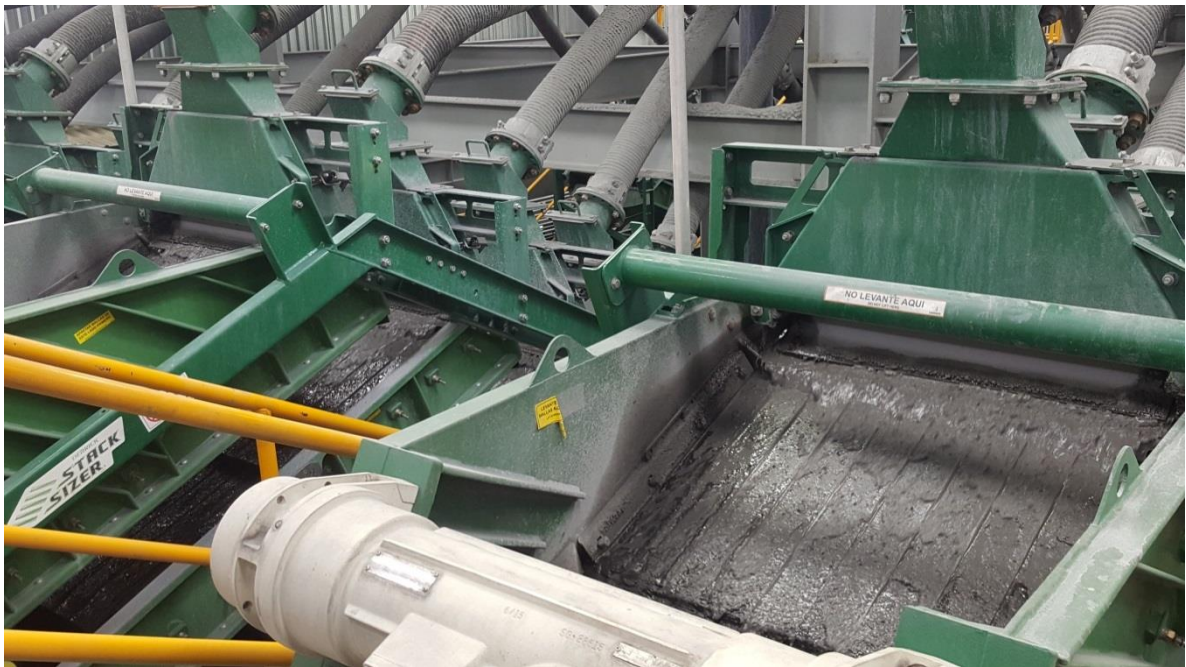
Fig. 12. Alimentación a las cribas derrick
