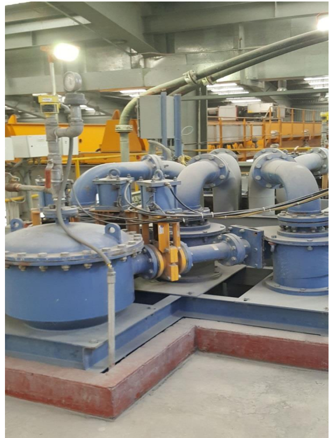
Figura. 19 Batería de hidrociclones
