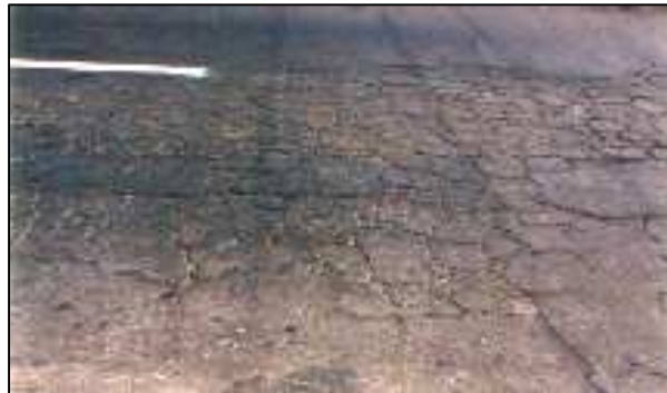
Agrietamiento en forma de piel de cocodrilo.
