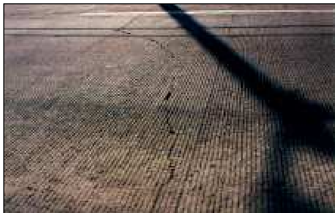
Grieta en el pavimento de concreto.
