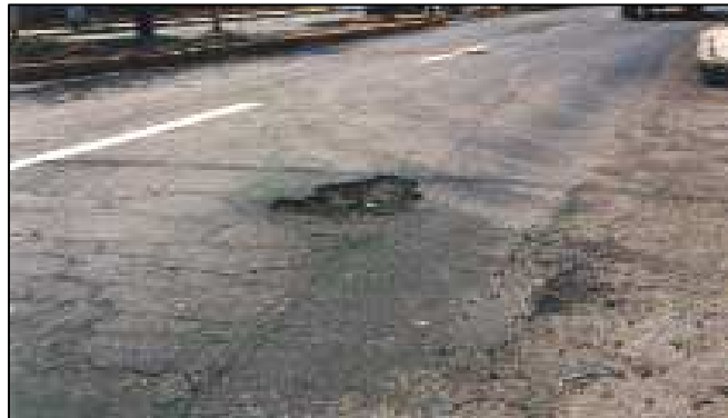
Un bache en la superficie del pavimento.
