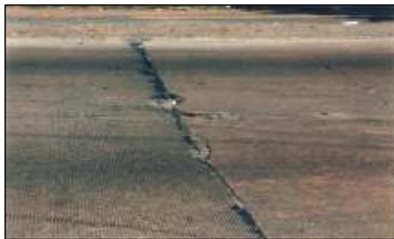
Despostillado de las juntas.
