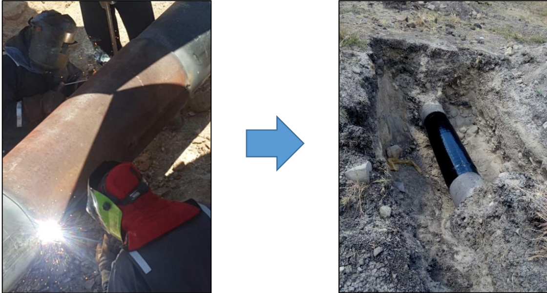
Figura D.2. Aplicación de recubrimiento en zona corroída en tubería (fotos originales tomadas en campo).
