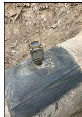
Figura 2.40. Toma clandestina en ducto de transporte [48].
