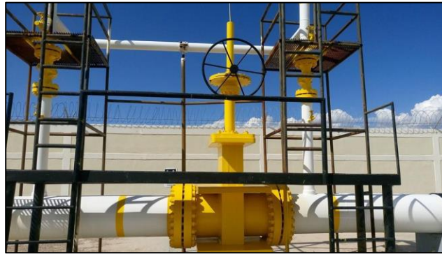
Figura 2.27. Válvula de seccionamiento de sistema de transporte [6].
