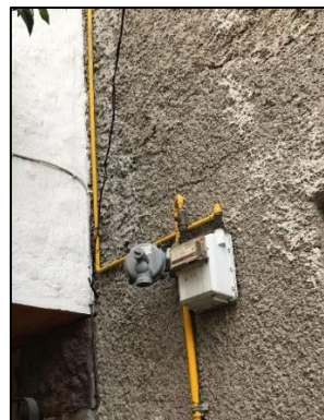
Figura 3.18. Instalación de sistema de medición y regulación a usuario del sector residencial (foto original tomada en campo).
