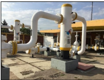
Figura 2.32. Filtros de retención de partículas sólidas (foto original tomada en campo).
