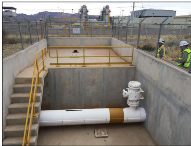
Figura 2.28. Registro subterráneo (foto original tomada en campo).
