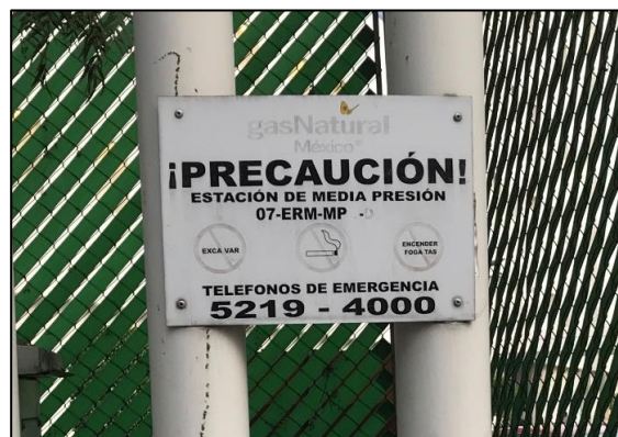
Figura 2.7. Ejemplo de placa de señalización en campo (foto original tomada en campo).
