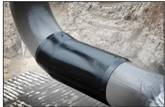
Figura 2.42. Envolvente en ducto de transporte de gas [49].
