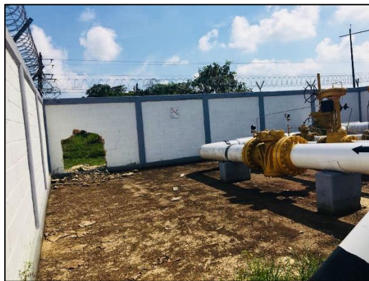
Figura 2.39. Trampa de Diablos vandalizada (foto original tomada en campo).
