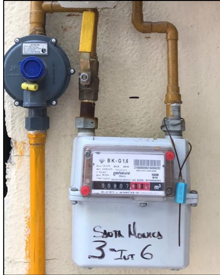
Figura 2.11. Instalación típica de un medidor de GN (foto original tomada en campo).
