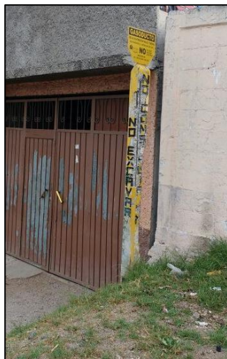
Figura 3.16. Poste de señalización de ducto de distribución de gas natural dentro del predio de una casa habitación (foto original tomada en campo).
