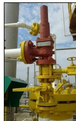
Figura 2.29. Válvula de relevo de presión (foto original tomada en campo).
