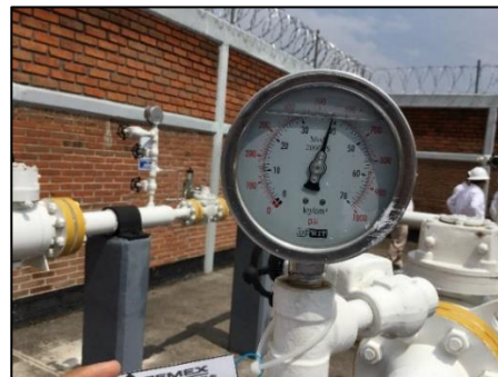
Figura 2.33. Medidor de presión manométrico (foto original tomada en campo).
