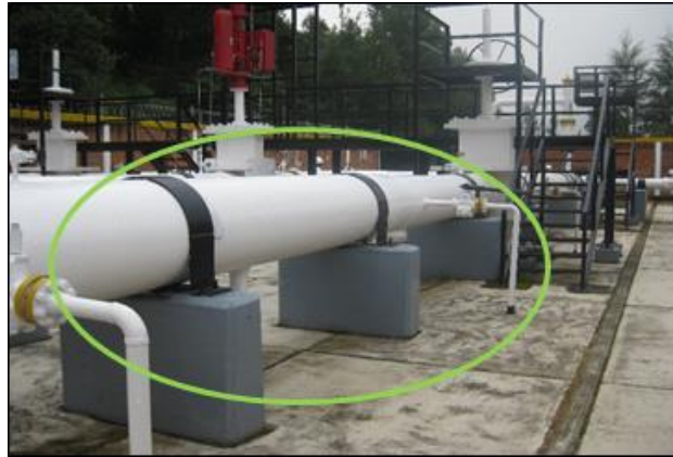
Figura 2.21. Soportes y anclajes de un ducto en un sistema de transporte (foto original tomada en campo).
