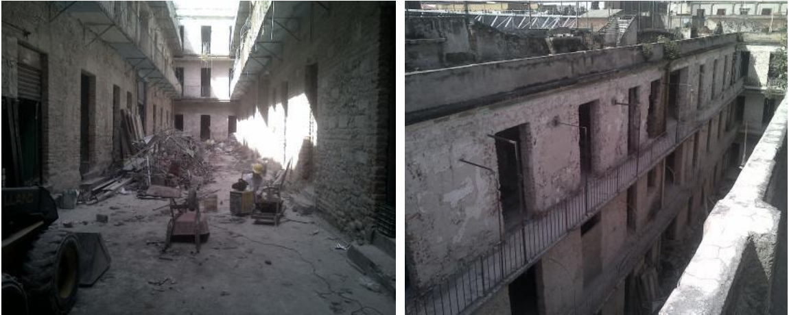
Imagen 38 y 39. Fotografías del inicio de la rehabilitación del inmueble. Fuente: Instituto de Vivienda de la Ciudad de México. Fecha de consulta 15 dic 2018
