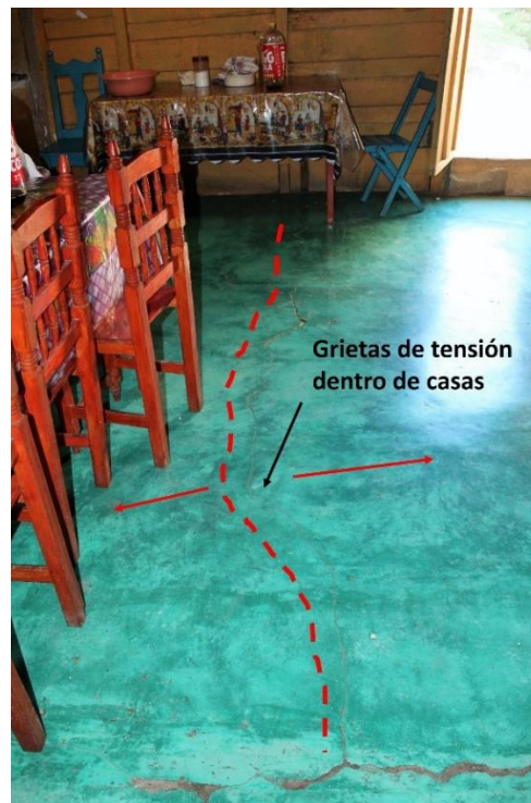
Figura 47. Grietas de tensión dentro de vivienda en zonas de deslizamientos al noroeste de la cuenca de Motozintla.
