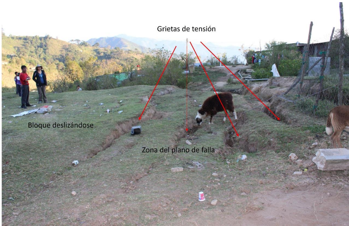
Figura 36. Grietas de tensión con aperturas entre 10 cm y 20 cm durante el desarrollo de un deslizamiento,
