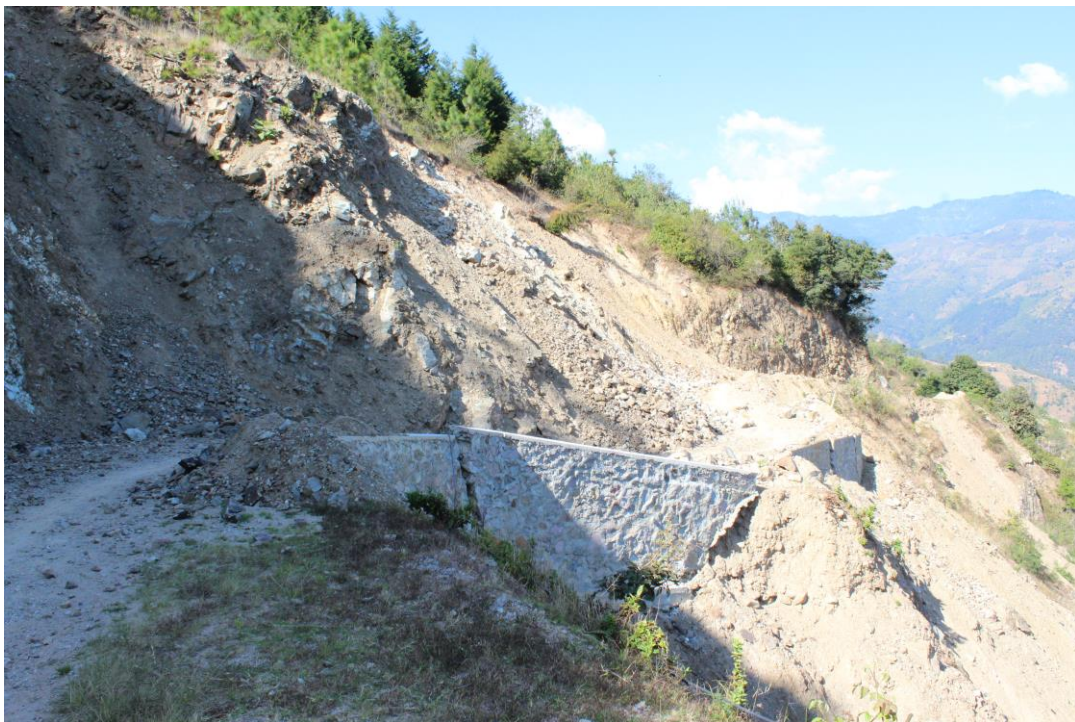
Figura 35. Medidas de contención inoperantes en zonas geológicamente inestables.
