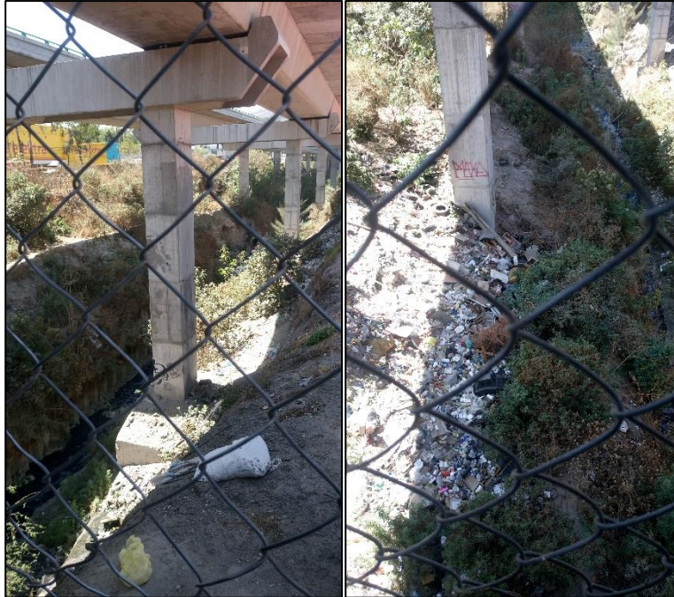
Fotos 11 y 12. Río de los Remedios (canal de aguas negras que atraviesa la colonia).
