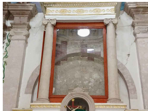
Grietas y aplanados sueltos en muro testero.
