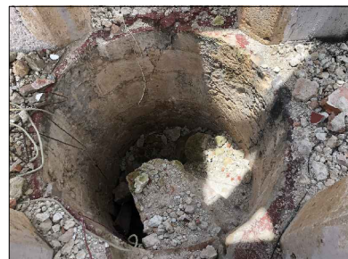
Desprendimiento y desfasamiento de escalones de cantera en torre campanario.
