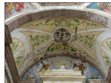
Humedad en cornisas pilastras y arcos de cantera. Presencia de grietas y fracturas en bóveda. Aplanados flojos y desprendimiento de dovelas de cantera en arcos.
