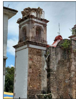
Perdida total de cupulin y perdida parcial de segundo cuerpo de torre. Fractura y grietas en muros. Desprendimiento de piezas de cantera en cornisa.
