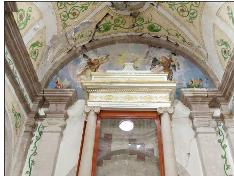
Humedad en arcos de cantera labrada. Grietas y aplanados sueltos en muro testero. Desprendimiento de dovelas de cantera en arco.
