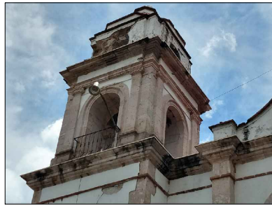
Perdida de juntas en sillares de cantera. Presencia de fractura y grietas en muros.
