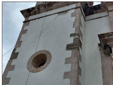
Grietas y aplanados sueltos en muros de torre campanario.
