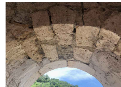
Perdida de juntas en dovelas de cantera labrada en arcos de torre campanario.
