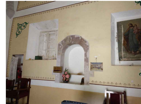
Grietas en muros y humedad en arco de cantera de vano tapiado.
