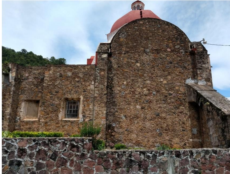
FIG. 25 Vista de la fachada posterior oriente del templo del Señor de Acatzingo, Acatzingo de la Piedra, Tenancingo. Se observa en primer plano, la fachada posterior oriente del templo, y en segundo plano, se aprecia la fachada posterior oriente de la sacristía. Imagen: Jessica Salazar. Consulta 12-11-2018.
