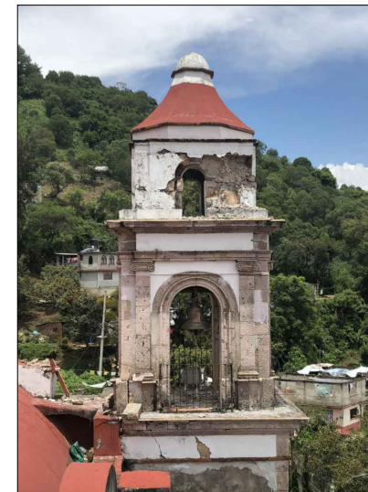
Perdida parcial de muro de mamposteria en segundo cuerpo de torre. Perdida de juntas en sillares de cantera.
