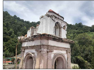
Perdida total de cupulin y perdida parcial de segundo cuerpo de torre campanario. Desprendimiento de sillares de cantera de cornisa.
