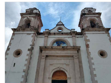
Perdida de juntas en elementos de cantera labrada en cornisas. Fractura de piezas de cantera labrada en entablamento.
