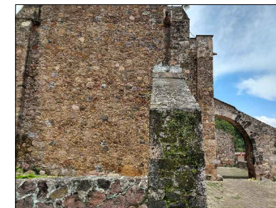
Microflora parasita en arco botarel causado por humedad.
