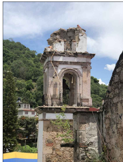
Perdida total de cupulin y perdida parcial del segundo cuerpo de torre. Desprendimiento de sillares de cantera en cornisa.
