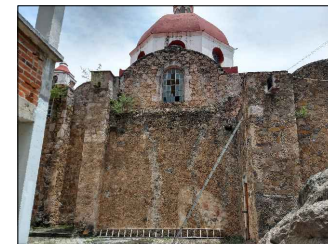
Resanes de grietas y mamposteo de muro provocado por sismos anteriores.
