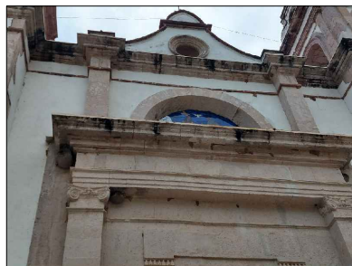
Grietas y aplanados sueltos en imafrente. Perdida de juntas en elementos labrados de cantera de cornisa.
