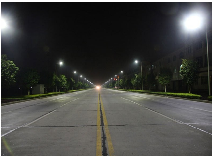
Figura 3.7 Alumbrado público operando lámparas de inducción electromagnética (IND).
