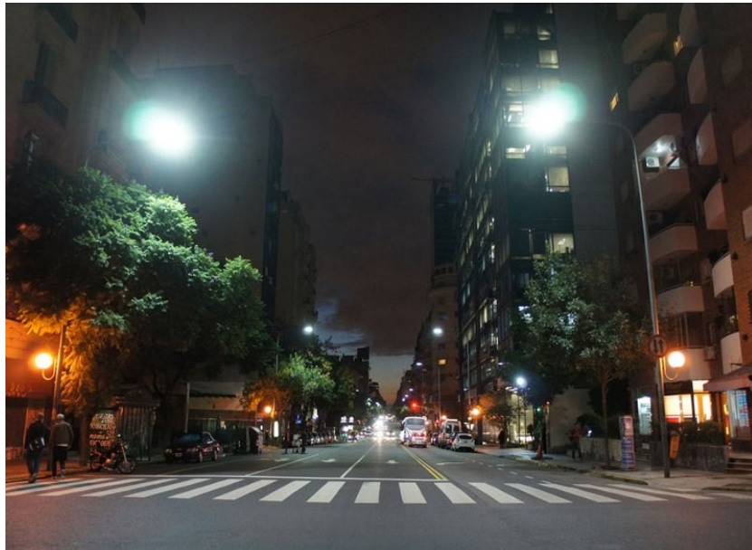
Figura 3.6 Alumbrado público operando módulos con Diodos Emisores de Luz (LEDs).
