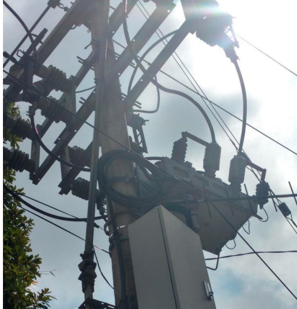
Figura 3.5: Equipo tele controlado con posibilidad de ajuste de protecciones.
