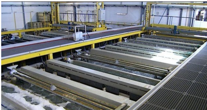
Figura 10: Tinas de lavado de una línea de recubrimiento metálico.
