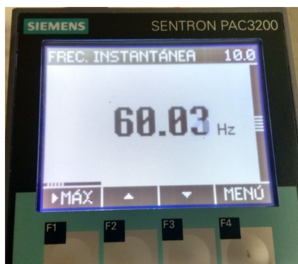
Figura 3.51. Medición de la frecuencia en la red eléctrica.
