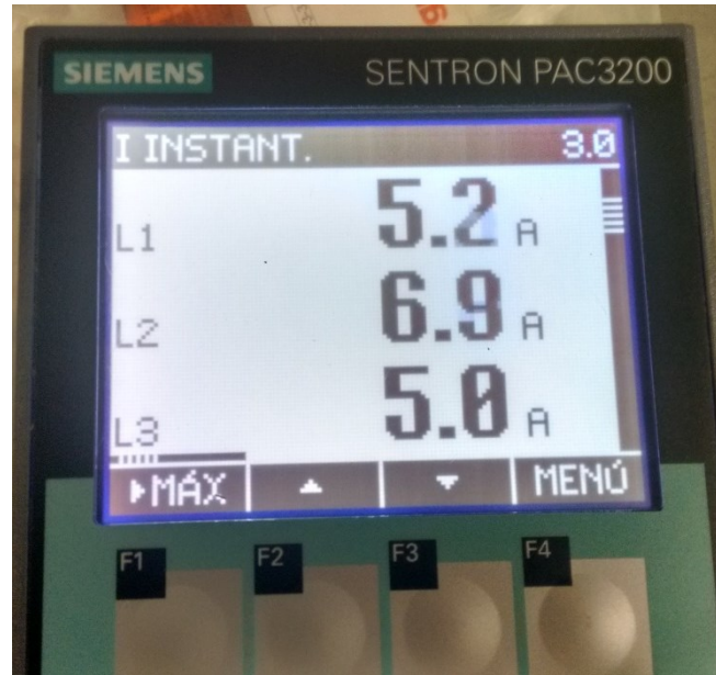
Figura 3.50. Medición de corriente en las líneas.
