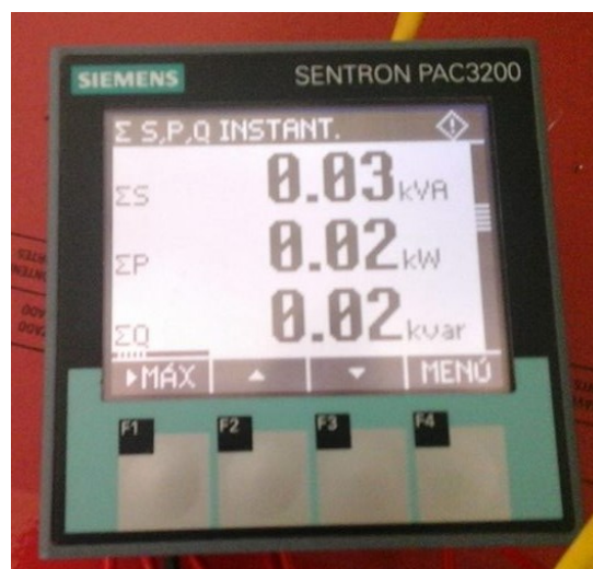
Figura 3.41. Medición de las potencias activa, reactiva y aparente totales.
