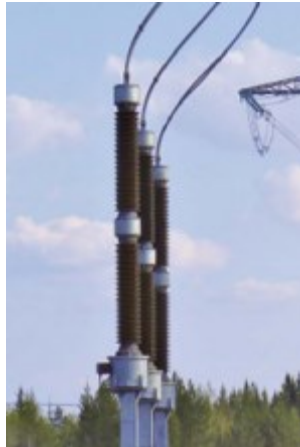
Figura 1.16. Transformador de potencial capacitivo.
