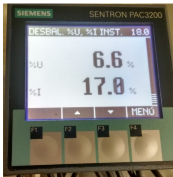
Figura 3.53. Porcentaje de desbalance entre tensión y corriente.
