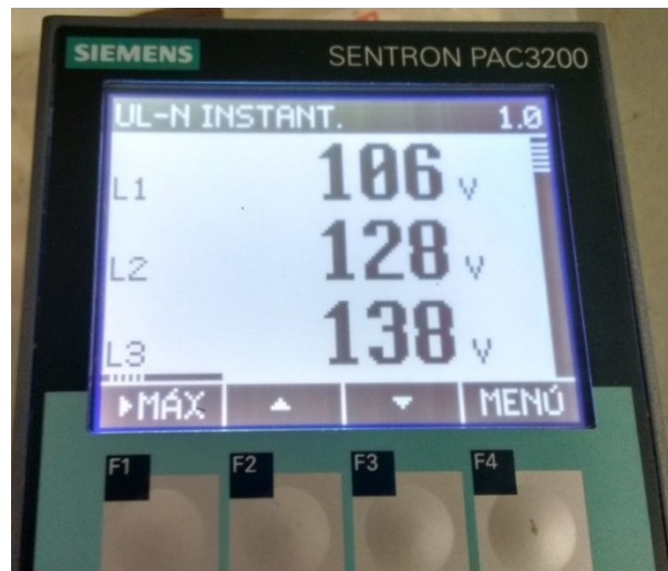
Figura 3.48. Medición de tensión de fase a neutro.
