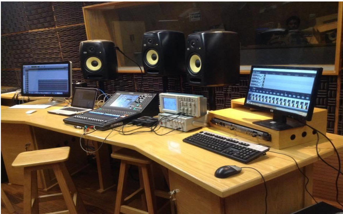
Figura 3.24 Conexión con 8 Dispositivos Dante en el cuarto de control.
