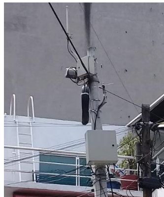
Figura 3.21. Ejemplo de instalación de los módulos de recolección de datos.
