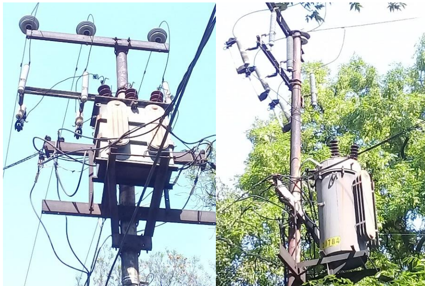
Figura 3.6. Equipo de distribución obsoleto detectado en la Red de Distribución del Polígono.
