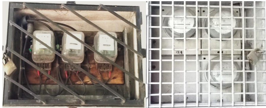
Figura 3.7. Medidores aún instalados en la Red de Distribución.
