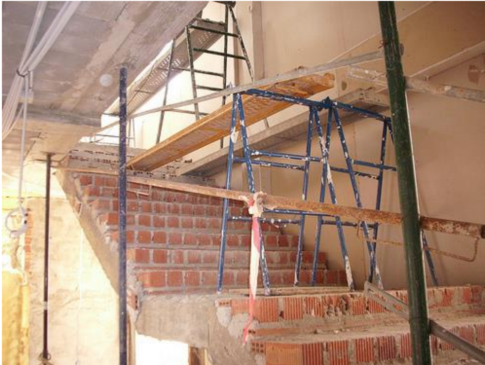
Figura 22 Escalera sin pasamanos
