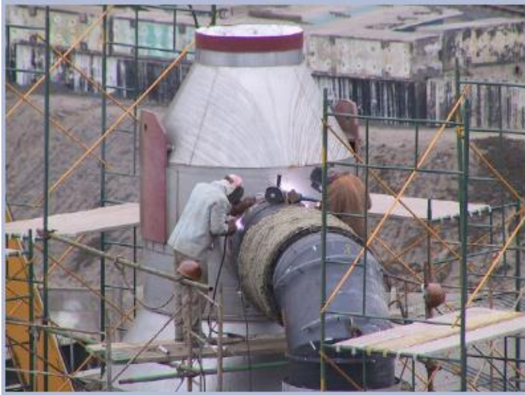
Figura 19 Ejemplo de obstrucción en una obra
