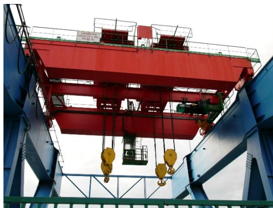
Fig. 1.18 Aplicación para resistencia de potencia, grúa puente.
