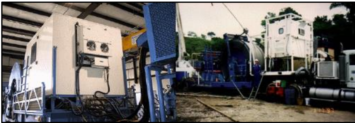
Figura 14 Cabina de control de la TF. (Alva, etc., 2011).
