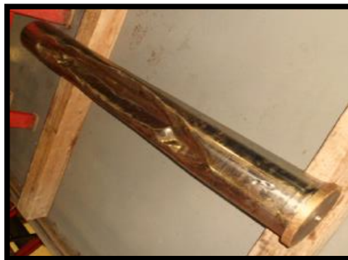
Figura I.15.- Falla por colapso (Muñiz, 2013)
