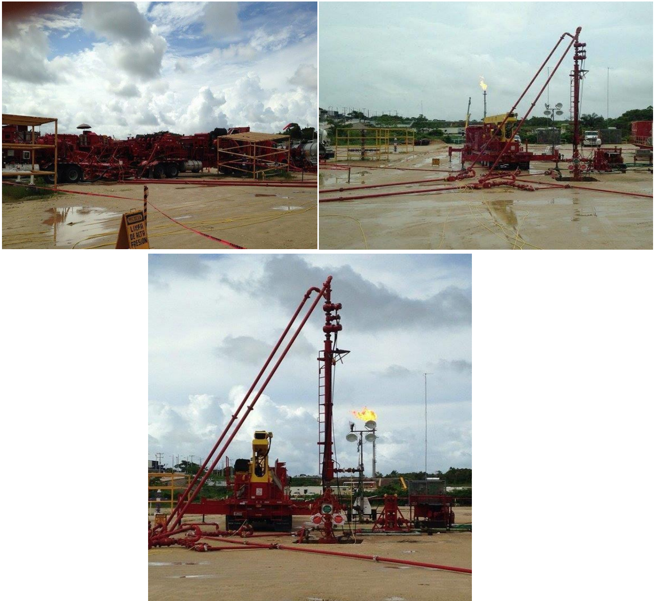
Figura 27.- Unidades de bombeo, pozos vecinos y pozo Jun 1 con equipo para prueba de Minifrac.
