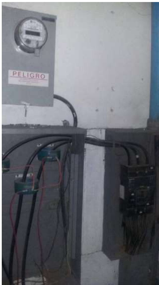
FIGURA 19 Medidor, interruptor principal y primer tablero de distribución.
