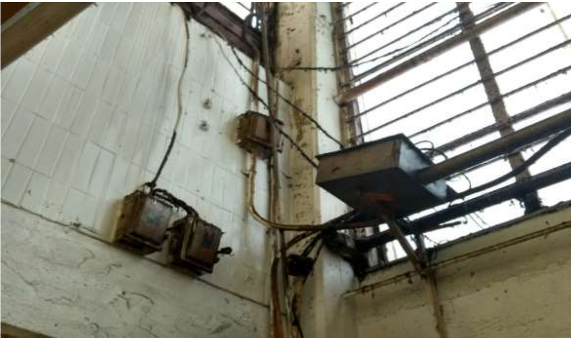
FIGURA 7 Conjunto de interruptores
