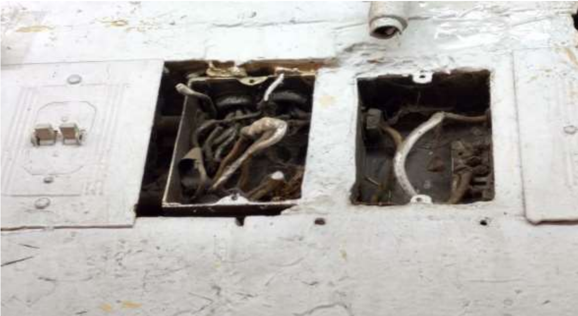
FIGURA 8 Pared con ausencia de interruptores.
