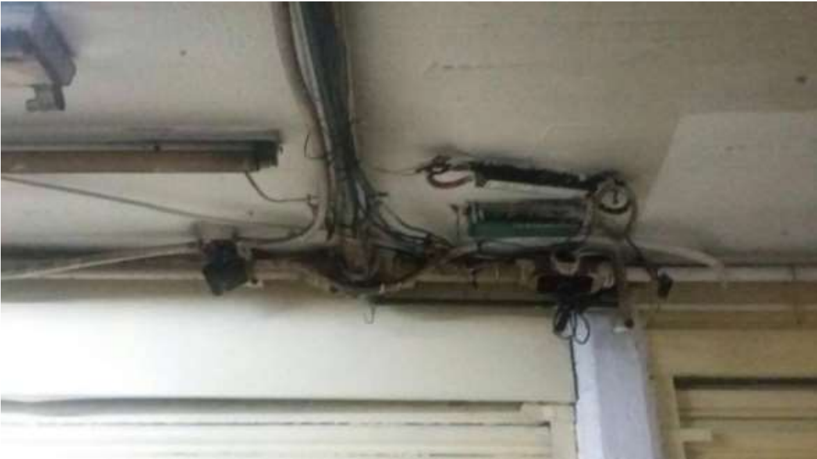
FIGURA 11 Conjunto de balastros, tuberías, cables y lámparas.
