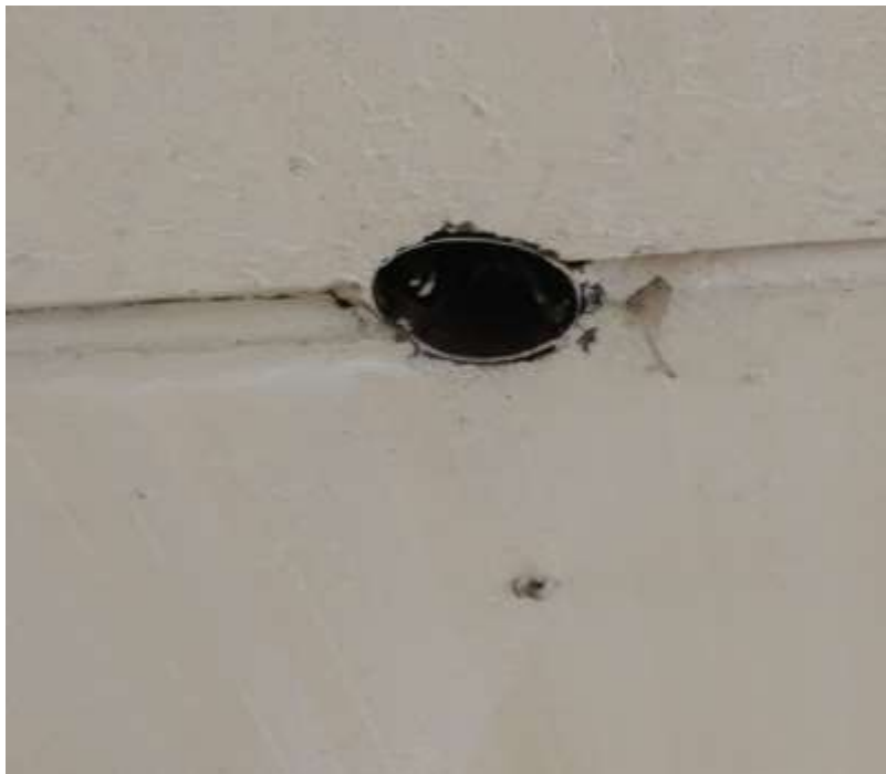
FIGURA 9 Pared con ausencia de interruptores.
