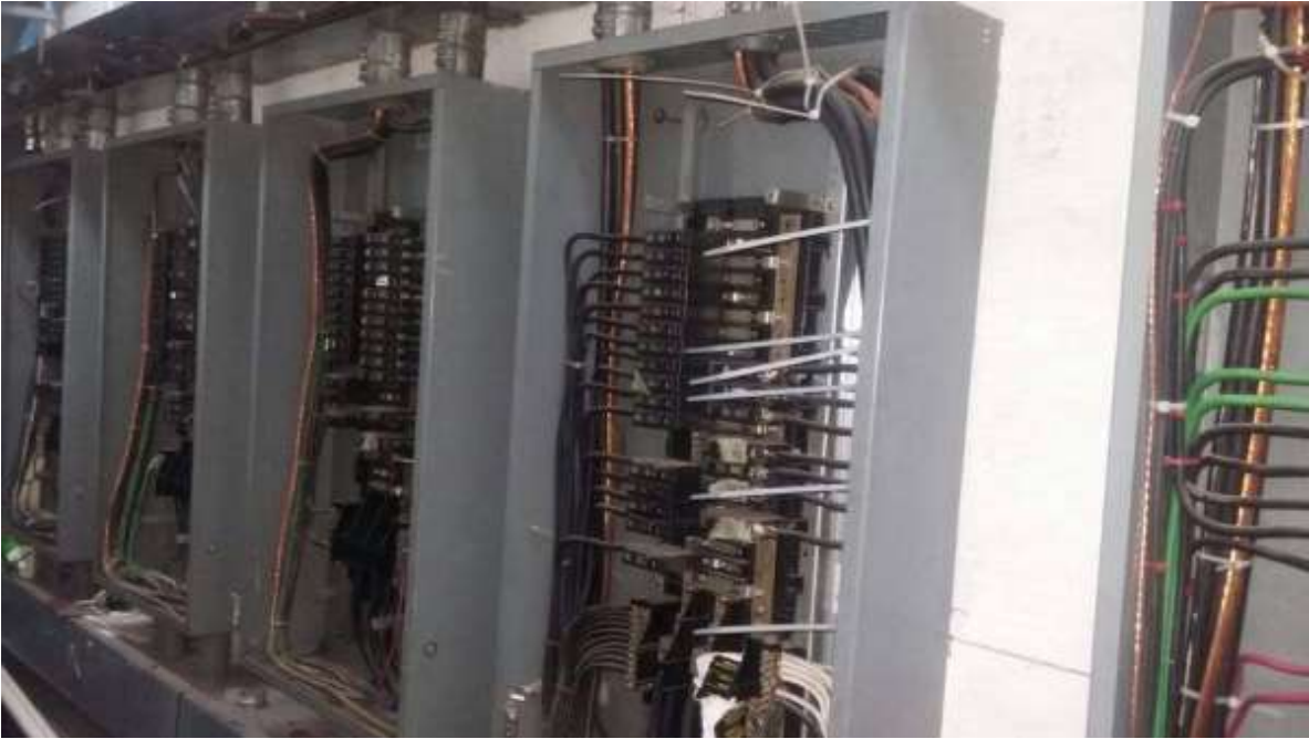
FIGURA 17 Fotografía de los tableros instalados en el mercado
