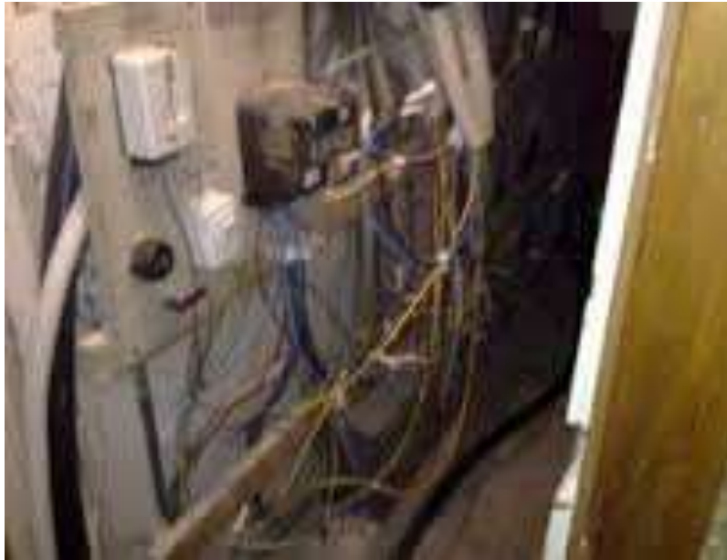
FIGURA 5 Fotografía de las conexiones mal establecidas del mercado
