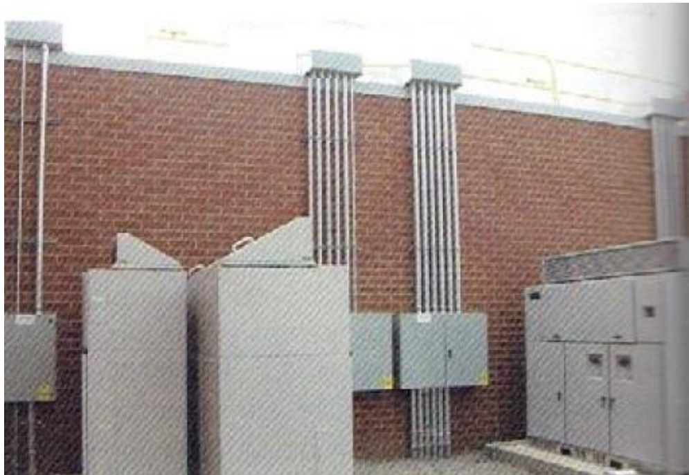
Figura 2.1 Correcta ejecución de trabajo en una instalación eléctrica. En Understanding the NEC (p.54) Mike Holt's 2014
