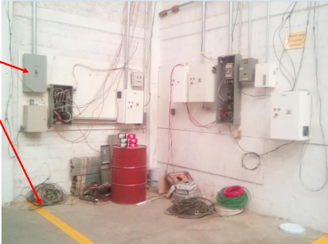
Figura 3.14 Área de tableros de subdistribución
