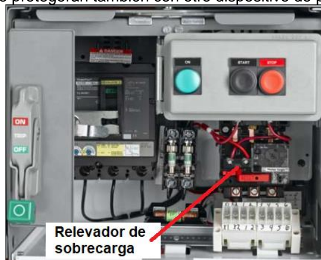
Figura 2.32 Protección mediante relevador de sobrecarga en cubículo de CCM. (Cortesía de Schneider Electric)
