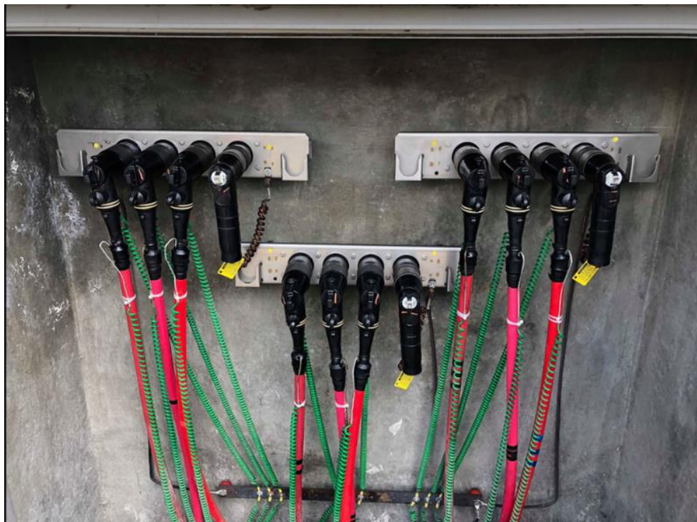
Figura 4.1 Conector múltiple de 4 vías tipo “J” en murete para media tensión
