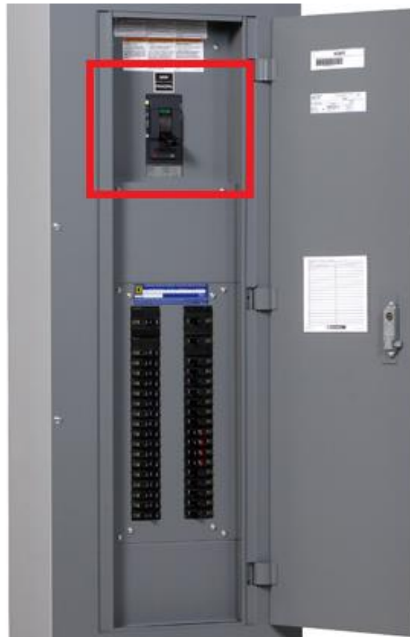
Figura 2.26 Tablero con interruptor principal. (Cortesía de Schneider Electric)
