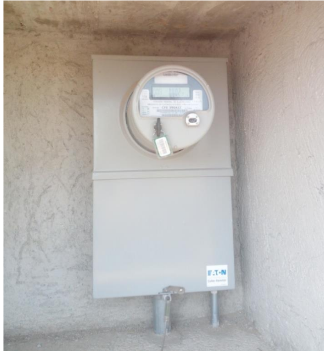
Figura 3.7 Multimetro digital de facturación instalado en baja tensión.
