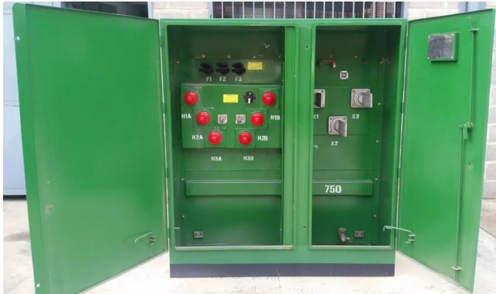
Figura 1.5 Transformador tipo pedestal con conexión en anillo. (Cortesía de ZETRAK)
