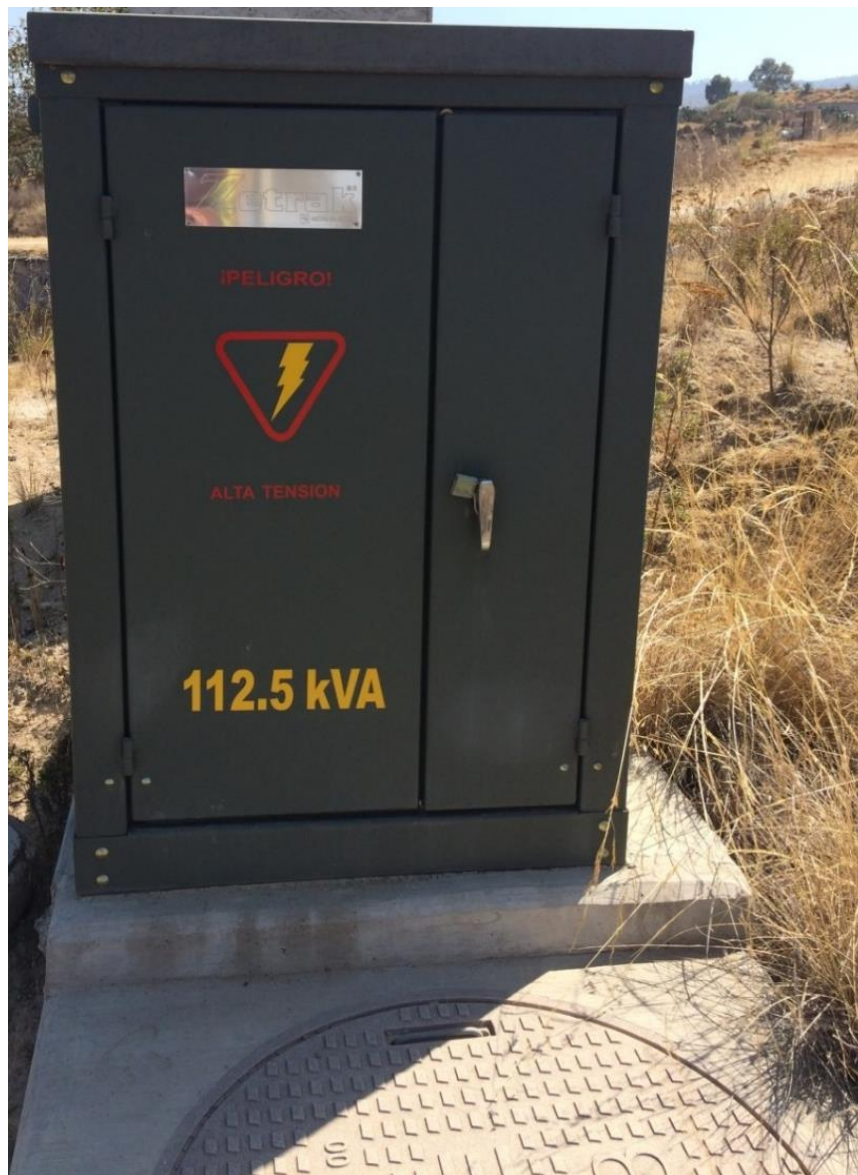
Figura 3.6 Transformador tipo pedestal radial de 112.5 kVA.
