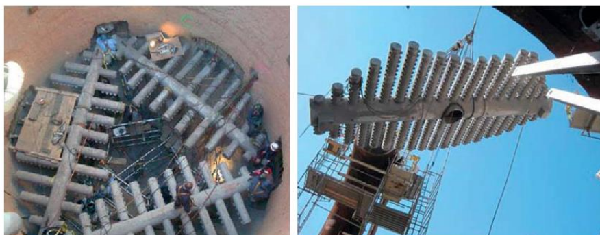
Figura 32. Ejemplos de Distribuidores de aire [10].
