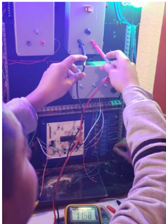
Fig. 4.1-2 Prueba de energización de la FA principal.
