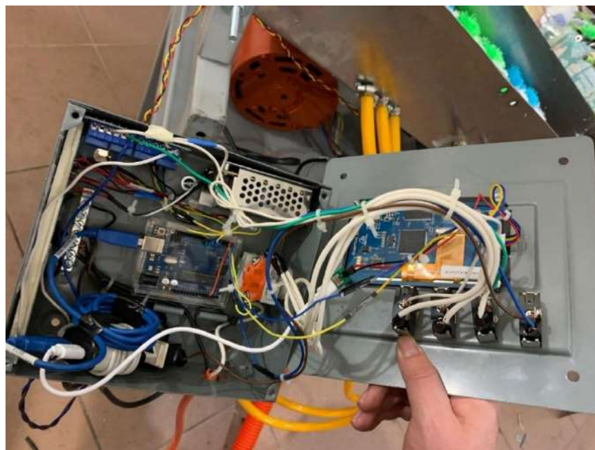
Figura 71. Cableado de conexiones eléctricas y electrónicas del gabinete de control.
