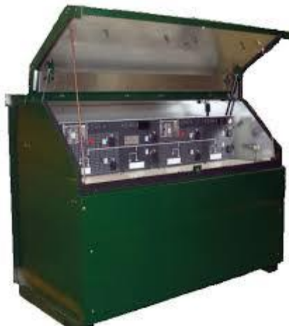
Figura 3.6 Gabinete de protección para el seccionador.
