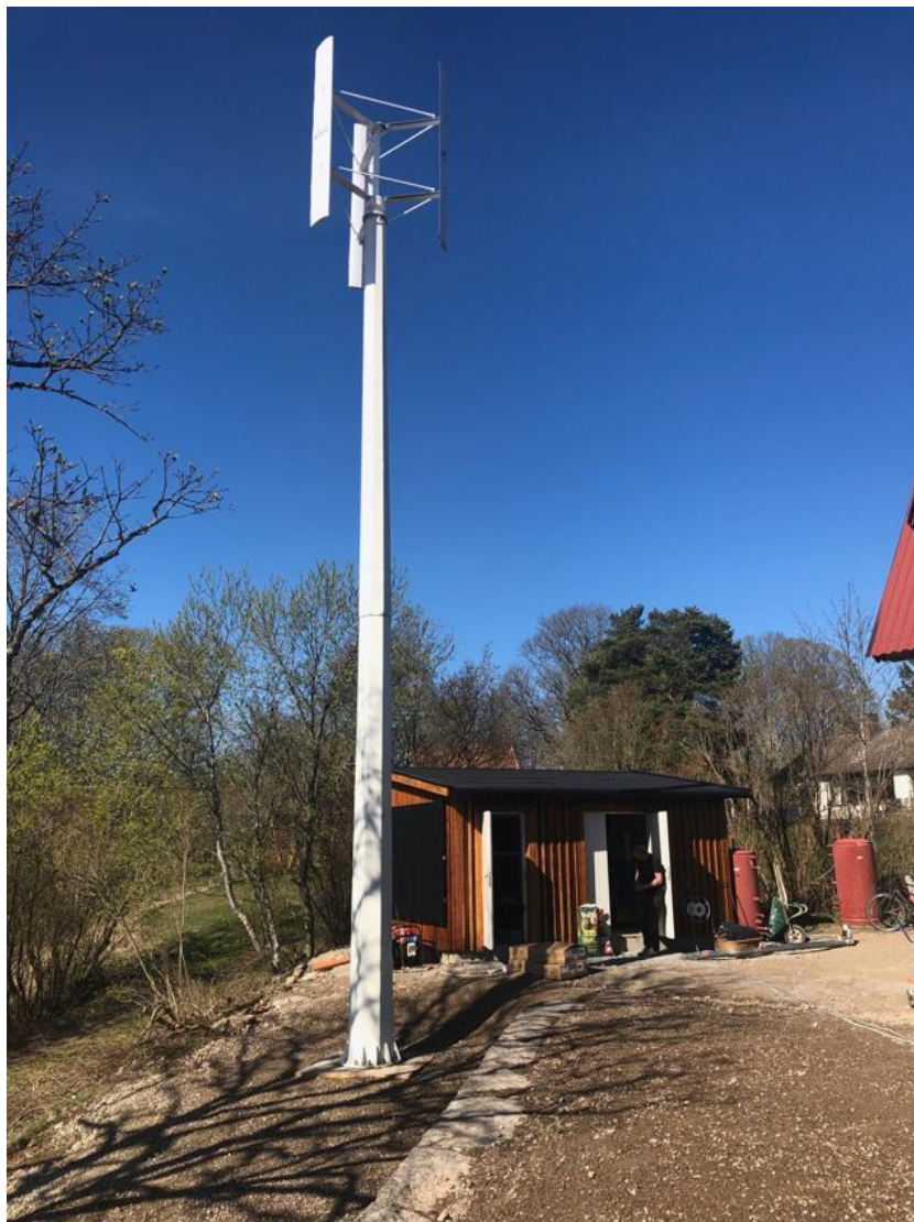
Figura 3.6 Aplicacion del aerogenerador Aeolos-V 1 KW
