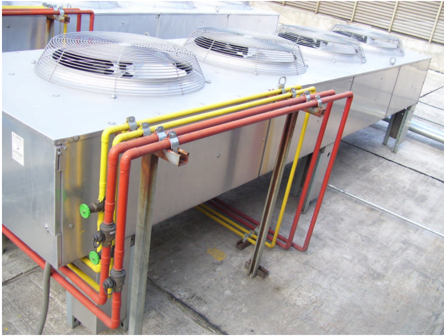
Fig. 20. Unidad condensadora ubicada en azotea y a la intemperie
