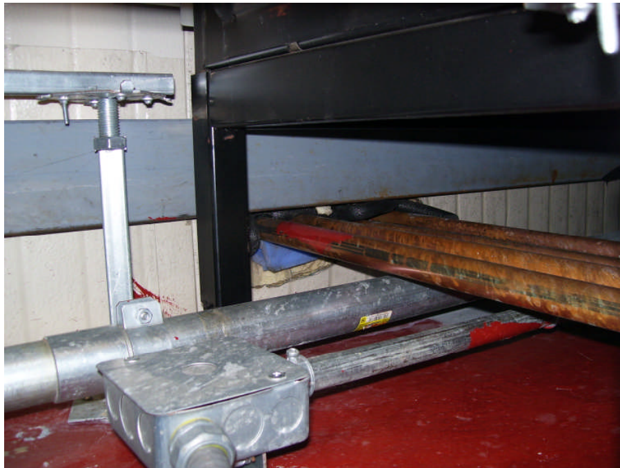
Fig. 19. Tuberías de succión y descarga hacia la condensadora
