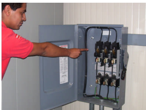
Fig. 25. Caja de fuerza principal.
