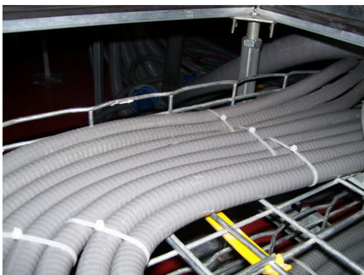
Fig. 24. Acomodo de cableado y tubería abajo del piso falso
