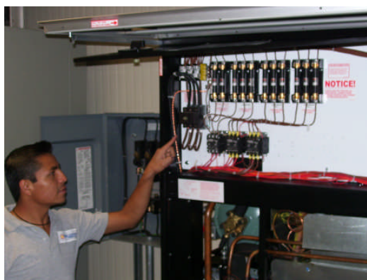
Fig. 27. Conexiones eléctricas en evaporador
