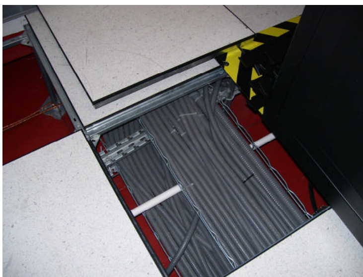
Fig. 23. Cableado debajo del piso falso.
