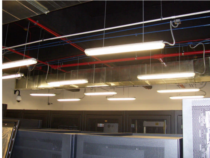
Fig. 11. Alumbrado dentro del SITE
