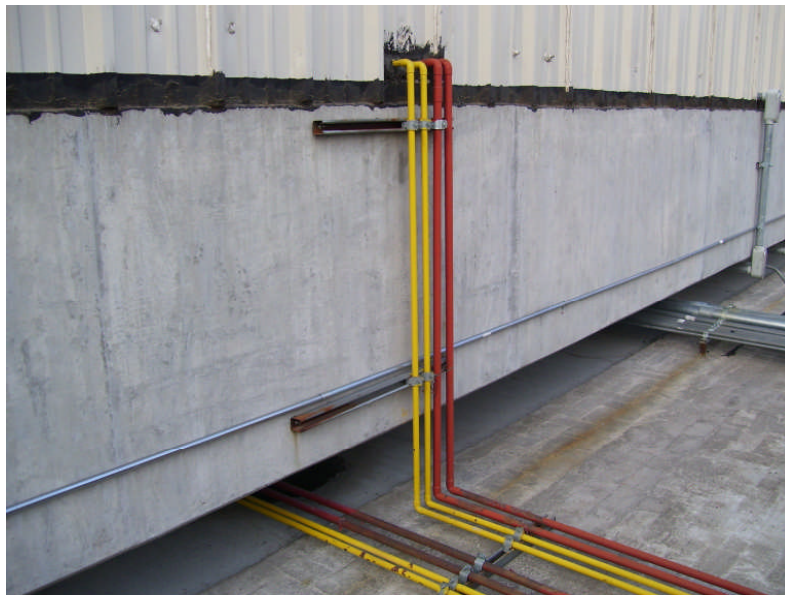
Fig. 17. Tuberías de succión y descarga hacia evaporador dentro del SITE
