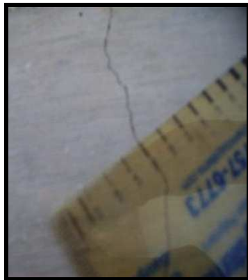
c) Grieta inducida de 0.2mm
