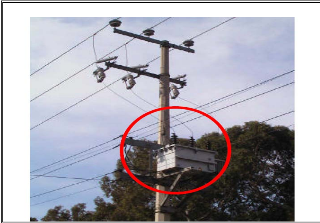
FIG. 3 .b. TRANSFORMADOR DE DISTRIBUCIÓN EN BAJA TENSION.
