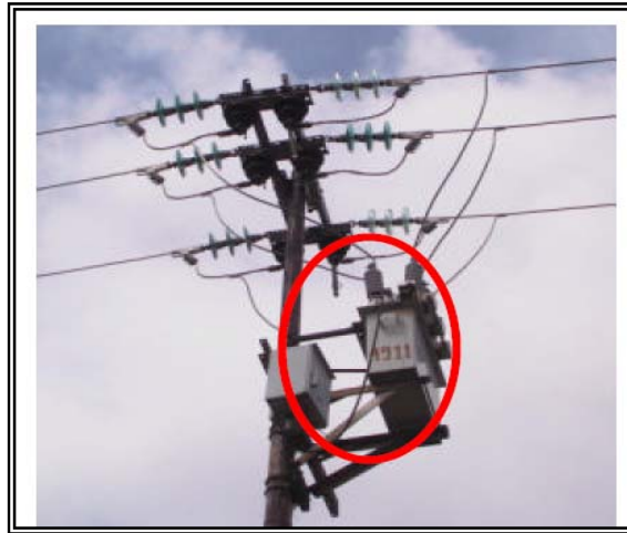
FIG. 9.b. SECCIONADOR UTILIZADO EN UN SISTEMA DE DISTRIBUCIÓN.
