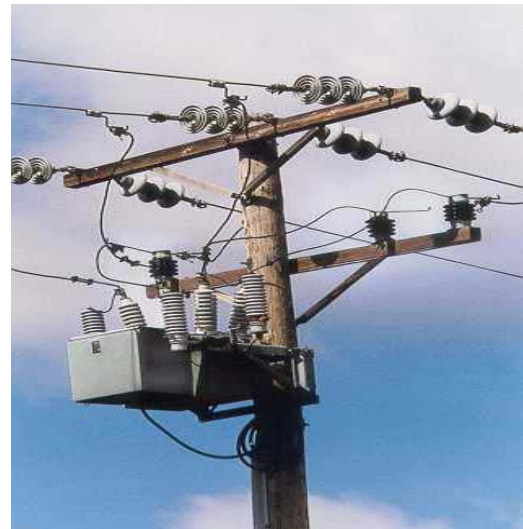
c).- Su colocación física en poste a la intemperie.
