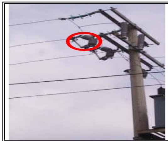
FIG. 7. CUCHILLA CORTACIRCUITOS FUSIBLE UTILIZADA EN EL SISTEMA DE DISTRIBUCIÓN
