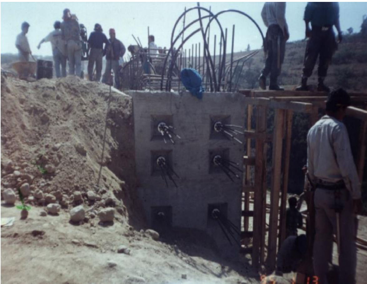
FOTOGRAFIA No. 12 Retenidas de cables de acero de \frac{3}{4} " Tensados a la estructura
