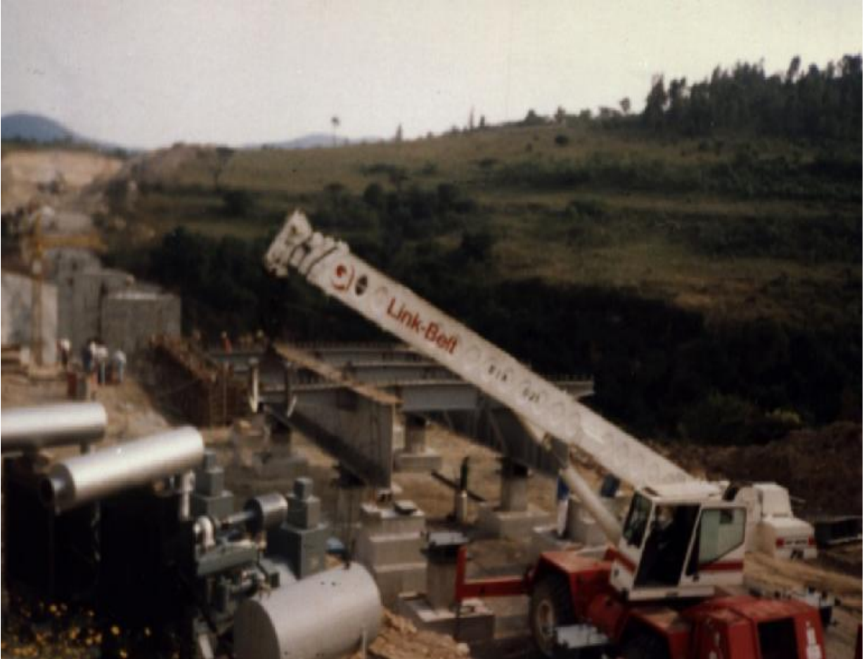
FOTOGRAFIA No. 29 Generador de luz y grúa de tránsito para maniobras.
