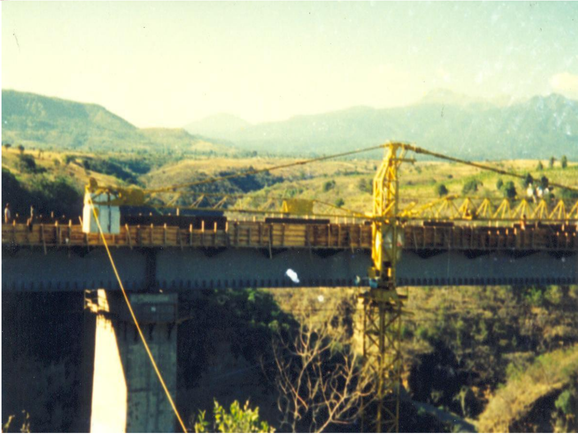
FOTOGRAFIA No. 14 Grúas con torres estacionarias en el viaducto “Calderón” para maniobras de materiales y equipos.
