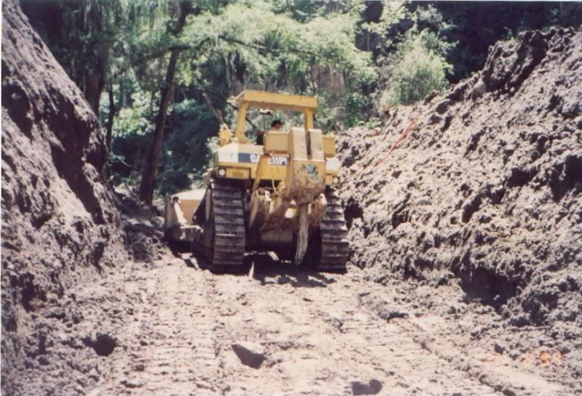
FOTOGRAFIA No. 31 Caterpillar D 8-K despejando el área de construcción haciendo remoción de escombros.
