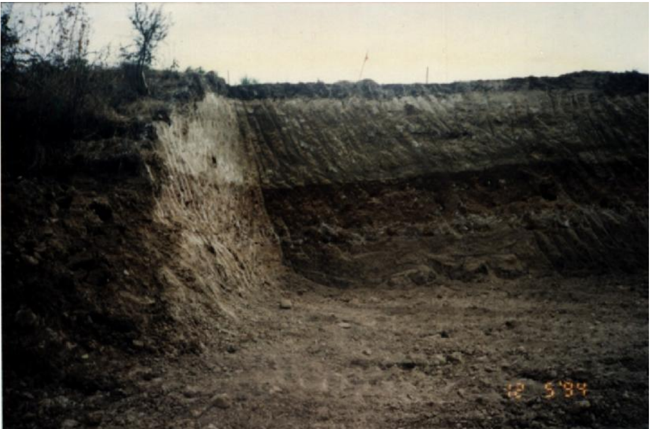
FOTOGRAFIA No 9.- Excavaciones en el desplante de pilas y estribos, verificando los centros de eje longitudinal y transversal del desplante de excavación.
