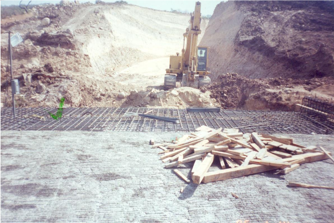
FOTOGRAFIA No. 30. Retroexcavadora caterpillar haciendo corte en el acceso para abrir el faltante de camino, uniendo puente y carretera.
