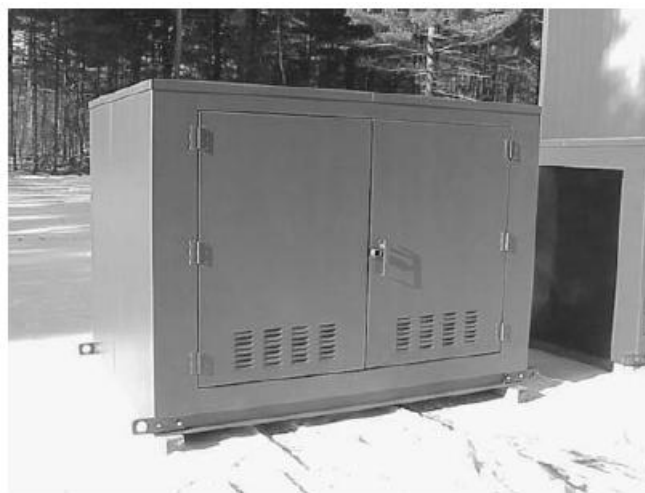
Figura 2.3 Ejemplo de un capacitor montado en base de concreto (De Northeast Power Systems, Inc.)
