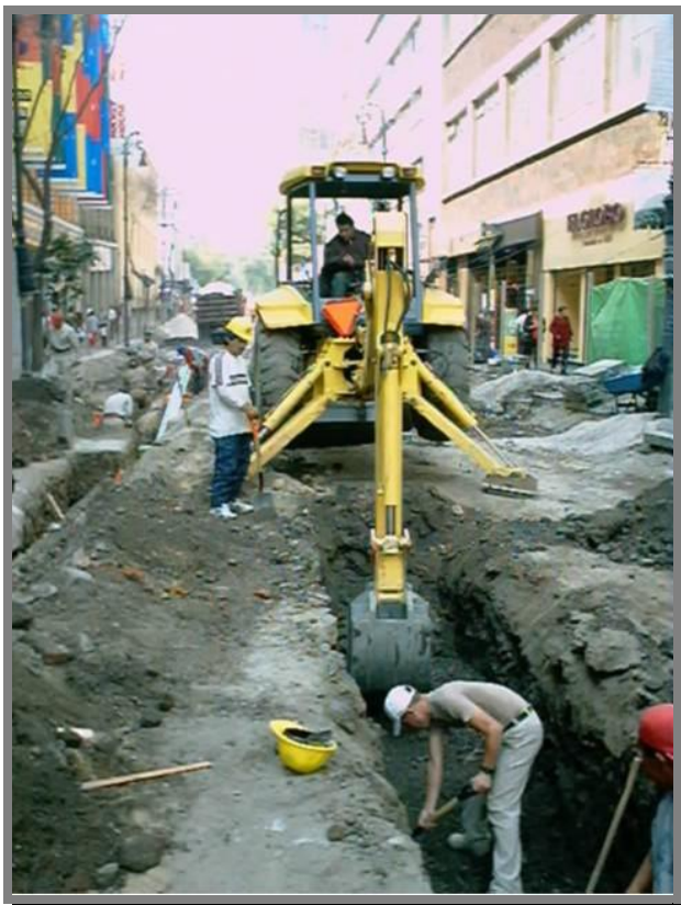
FOTO 15.-Excavación de zanja con medios mecánicos en los sitios donde se ha reconocido que no existe problema con las instalaciones existentes y afinado a mano del fondo y las paredes para evitar derrumbes.
