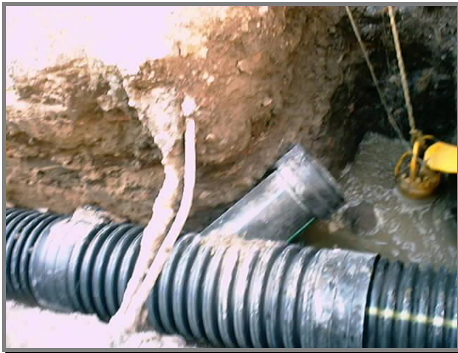
FOTO 21.-Instalación de las piezas especiales de las descargas domiciliarias equivalentes a los tubos slant's.
