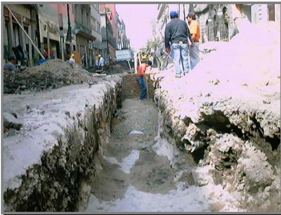
FOTO 51.-Relleno de arena de 30 a 40 cms. Por encima del lomo de la tubería de polietileno de alta densidad.
