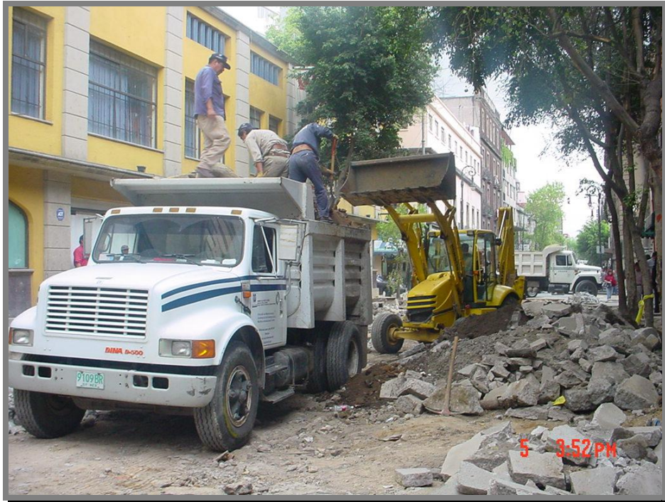
FOTO 10.-Retiro del material de demolición de la carpeta de rodamiento y corte de la base y sub-base.
