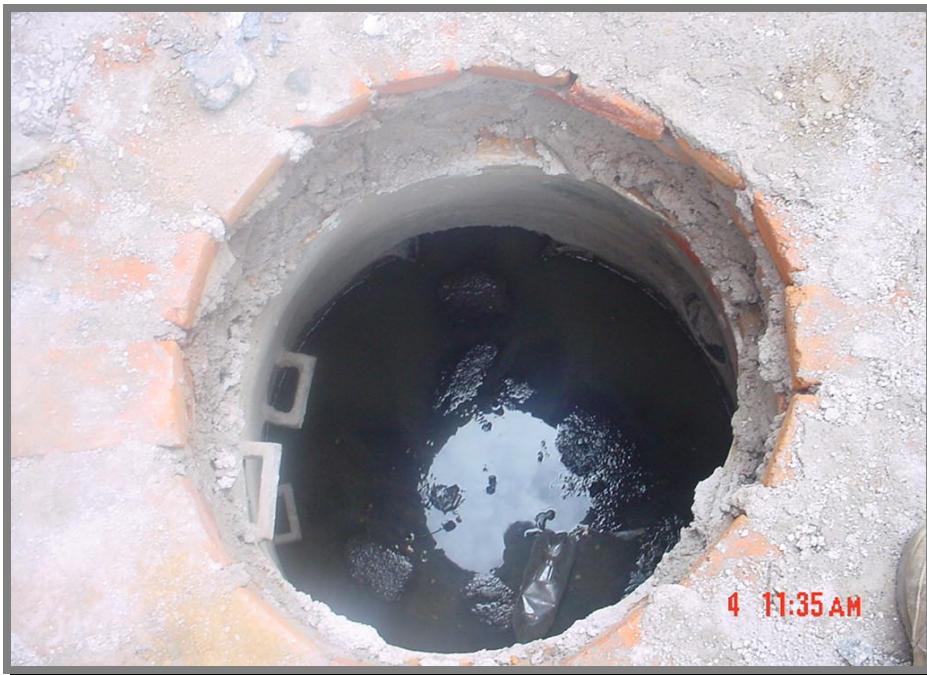
FOTO 5.-Definición de los tramos y estructuras que requieren Rehabilitación con carácter de urgencia debido a que se encuentran en contra pendiente o colapsados.
