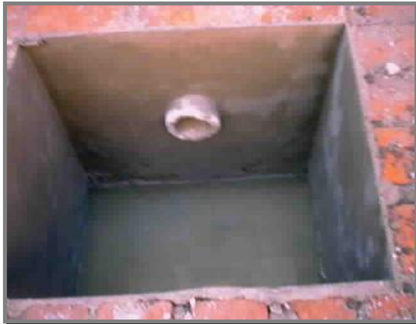
FOTO 46.-Aplanado del interior del registro con mortero cemento-arena 1:3. Hace falta recortar el tubo de descarga al paño interior del registro
