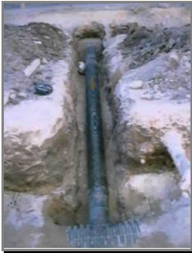
FOTO 46.-Descarga de una coladera pluvial a la red municipal.
