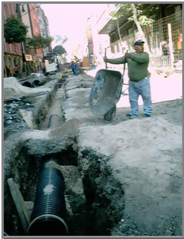
FOTO 48.-Relleno de la zanja formando atraques con muertos de arena a volteo, el resto se rellenó con concreto fluido.
