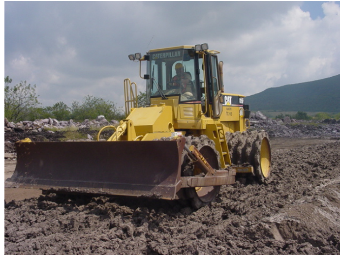
Fotografía No. 14: otra toma de la colocación de material de arcilla compactado con rodillo pata de cabra
