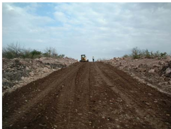
Fotografía No. 44.- colocación y conformado de material de grava arena para el revestimiento del camino
