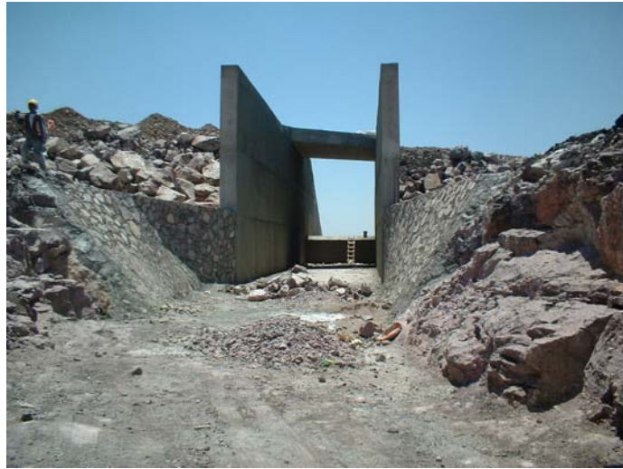
Fotografía 32: muros de mampostería en la zona de transición y vista del vertedor
