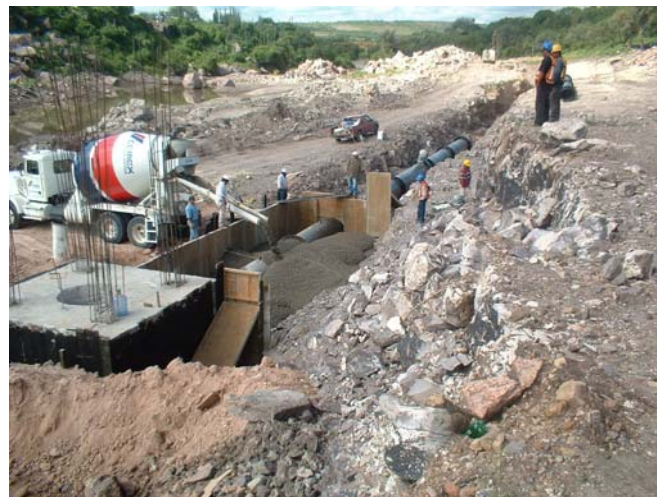
Fotografía No. 28: otra toma de la colocación de tubería de desagüe de fondo y su encofrado
