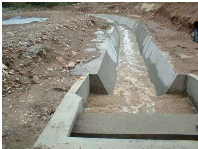
Fotografía 30: caja disipadora y canal de desagüe en funcionamiento
