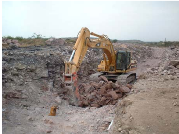
Fotografía 34: excavación de canal de descarga mediante excavadora caterpillar 330B equipada con martillo hidráulico
