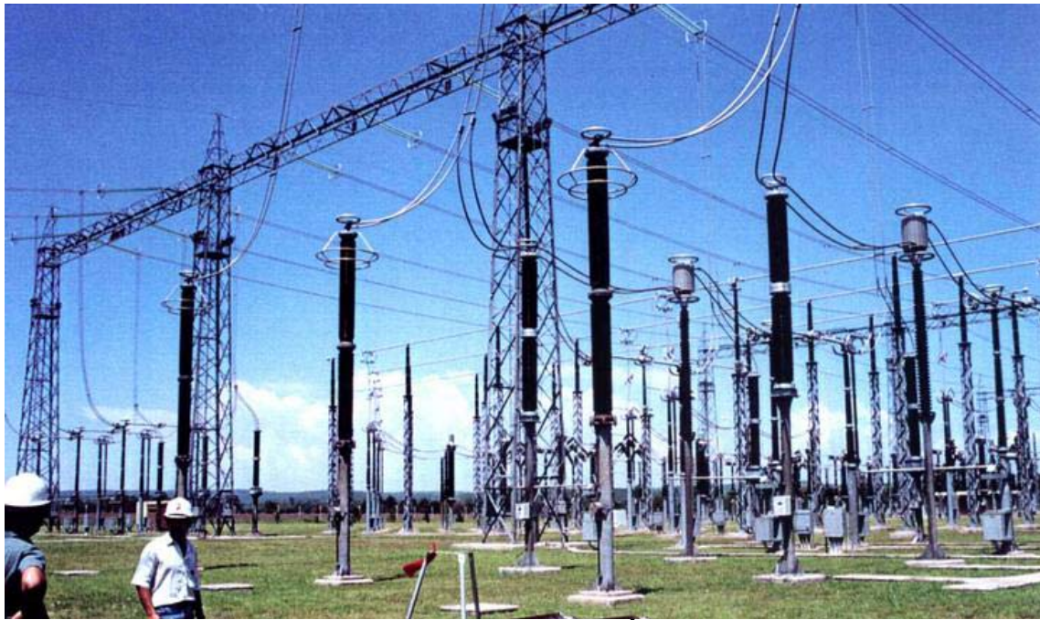
Figura A. SUBESTACIÓN AIS
