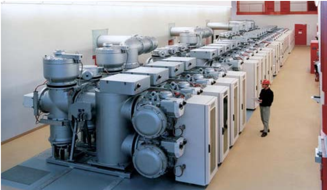
Figura B. SUBESTACIÓN GIS
