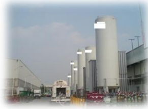
Ilustración 32. Tanques de almacenamiento de gases industriales y medicinales
