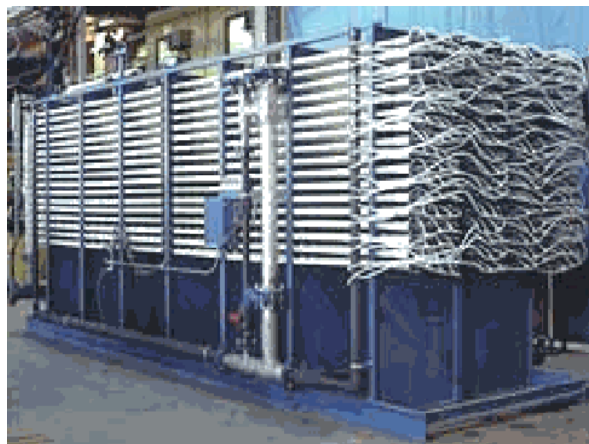
Figura No. 30 Equipos para el proceso de Microfiltración.
