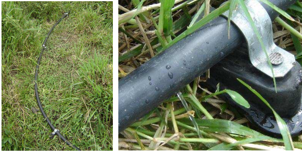
Fig. 4.6 La red de distribución, tendida y con presión suficiente. Elaboración Propia
