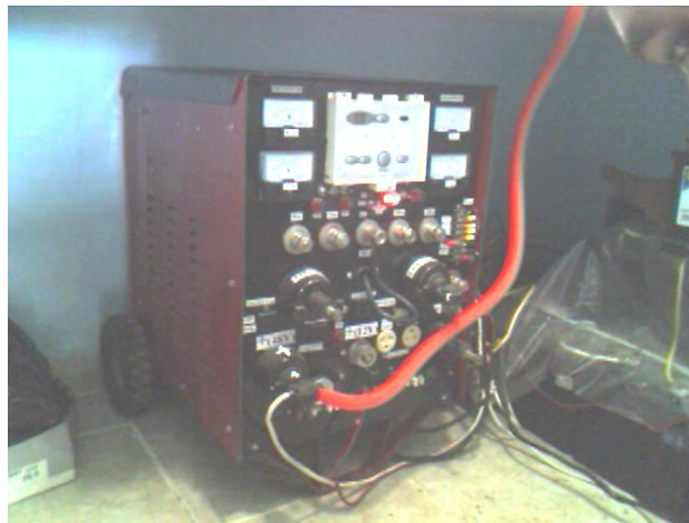
Figura 4.5.2.1. Fotografía que muestra la instalación del “SICITSAE” junto con su banco de baterías funcionando en óptimas condiciones en el ambiente real, fuente propia.
