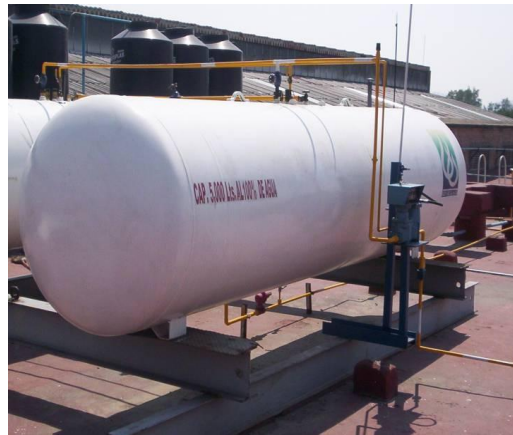
Imagen 8. Línea de servicio para el suministro a equipos de consumo y tanques de almacenamiento 5000 lts. 2008.
