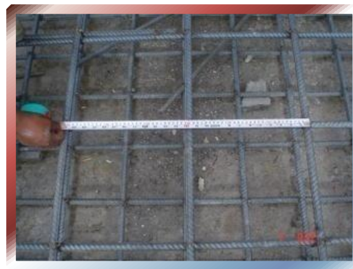
FOTO Nº 32 –Separación de varillas superiores de cimentación.
