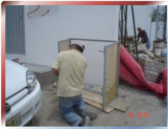
FOTO Nº 77 –Herrería puerta de equipos de medición
