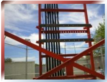
FOTO N° 83 –Interconexión de barras BTF con cable aislado.
