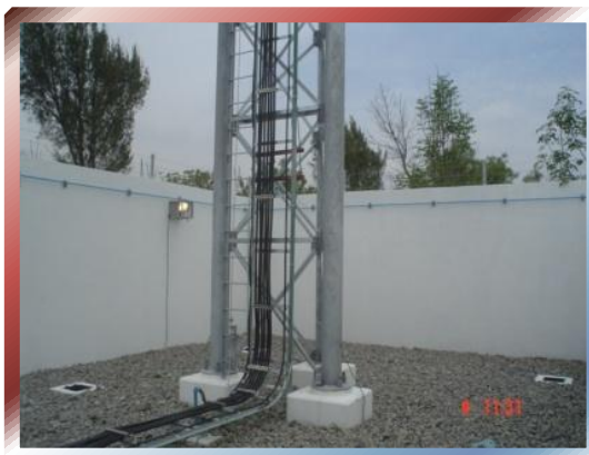
FOTO Nº 103 –Líneas sobre porta cablera de torre esbelta.
