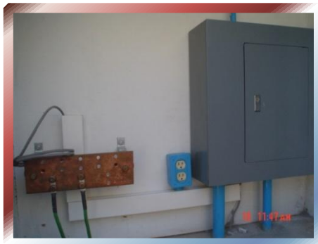
FOTO N° 87 –Barra colectora BTCC
