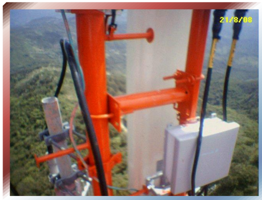
FOTO Nº 105 –TMA a espalda de Antena.
