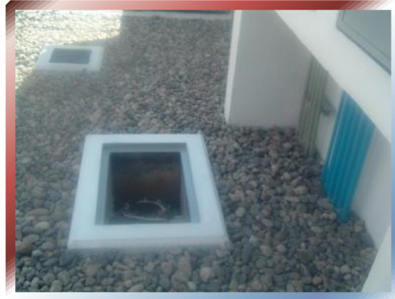
FOTO Nº 74 –Registro eléctrico y de sistema de tierras.
