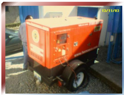
FOTO № 109 – Planta de emergencia de 240 V
