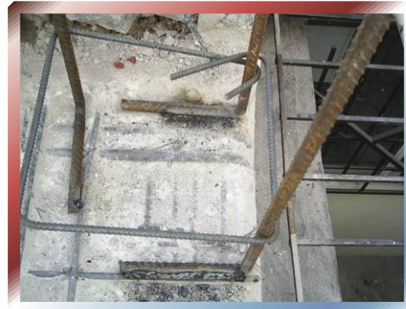
FOTO Nº 35 –Anclaje de retenida.
