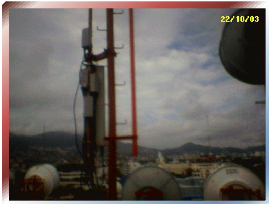
FOTO Nº 101 –Antena sobre Mástil tipo Bandera
