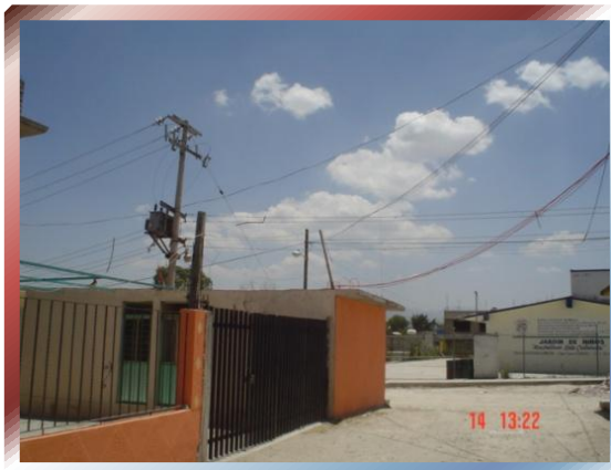
FOTO № 121 – Distancia mínima de 30 m. a transformador
