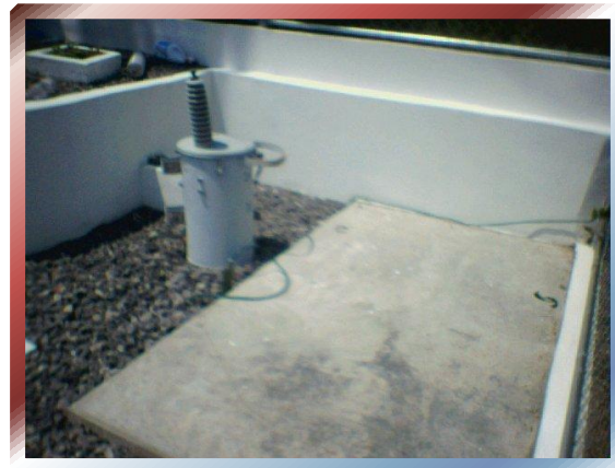
FOTO № 120 –Subestación tipo unicornio de una solo fase.
