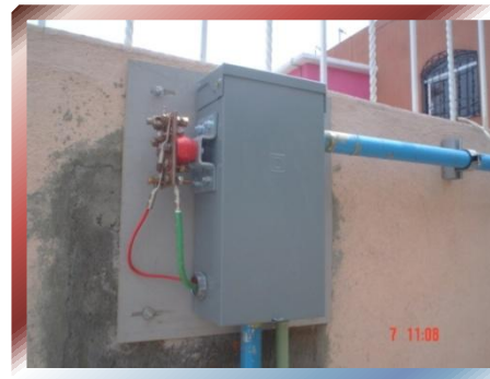
FOTO N° 88 –Barra BTA en interruptor principal.
