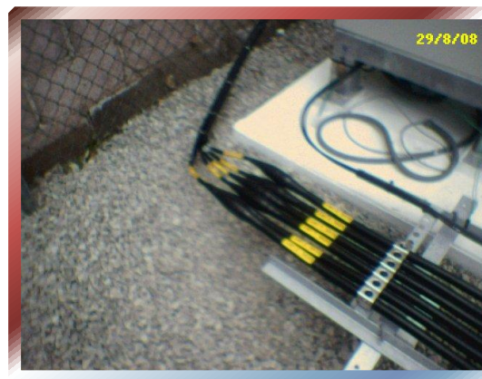
FOTO Nº 104 – Conexión Feeder's –Jumper's.
