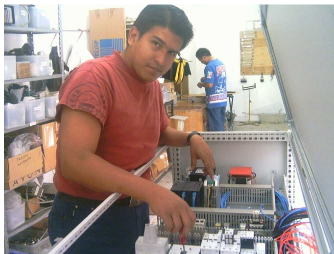
Figura 25.- Armado del gabinete de control del granulador de lecho fluido “GLATT”. Junio 2005, para Medix México.
