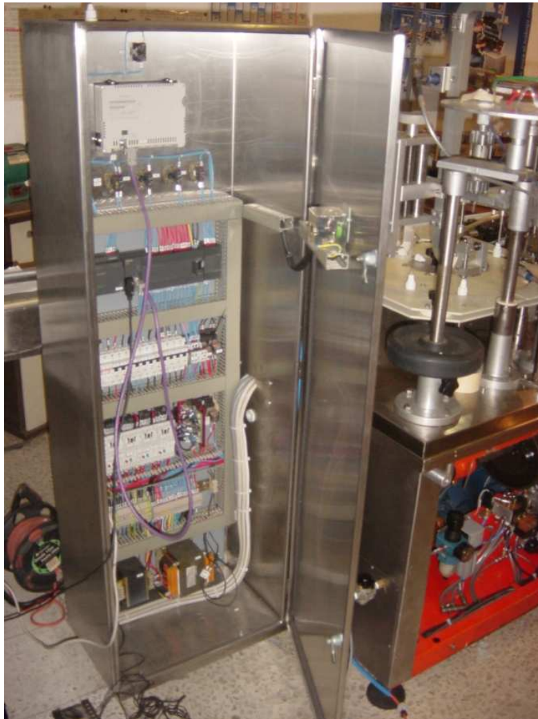
Figura 19.- Tablero de control de la máquina circular llenadora de líquidos, luego de su remodelación. Mayo 2005, para Offenbach México.
