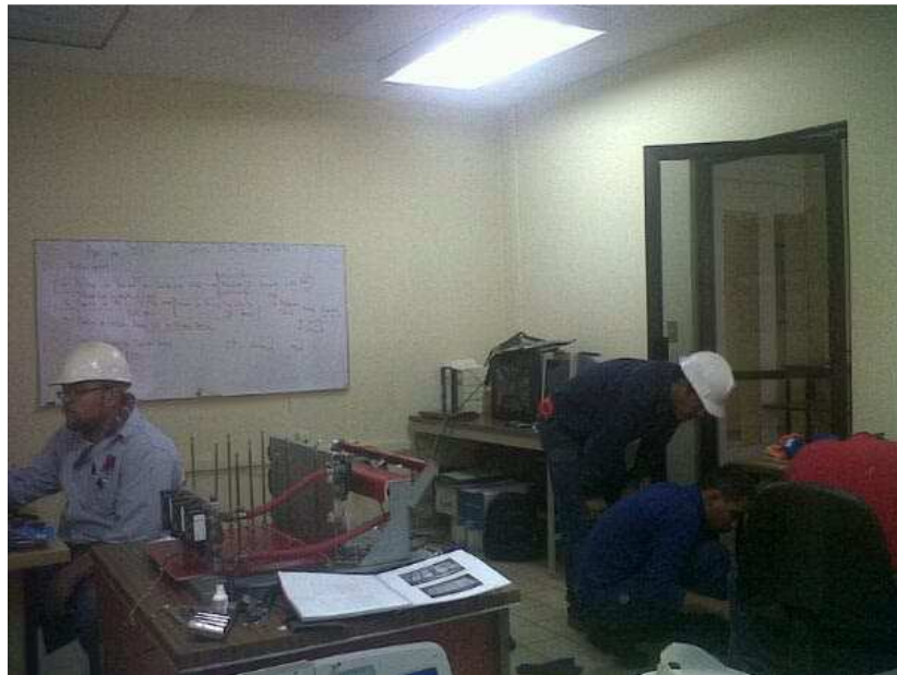
Figura 40.- Mantenimiento a un módulo de potencia del chopper de UDHE. Marzo 2011, para ROT Química, Monterrey México.
