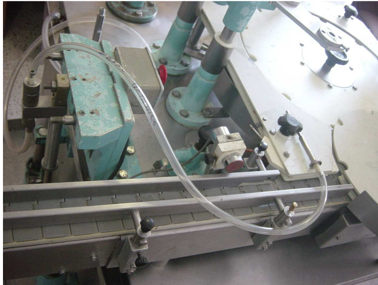
Figura 14.- Etapa de entrada de frascos. Nótese que solo hay sensor de presencia de frasco. La manguera que tiene una jeringa metálica al final se utilizaba para llenar manualmente los frascos que entraban a la máquina. Máquina original. Marzo 2005, para Offenbach México.
