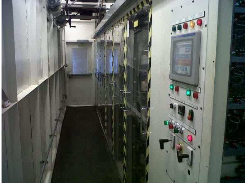
Figura 37.- Pasillo del chopper de UDHE. Las pantallas de policarbonato resguardan al operador de los módulos de potencia. Julio 2011, para ROT Química, Monterrey México.
