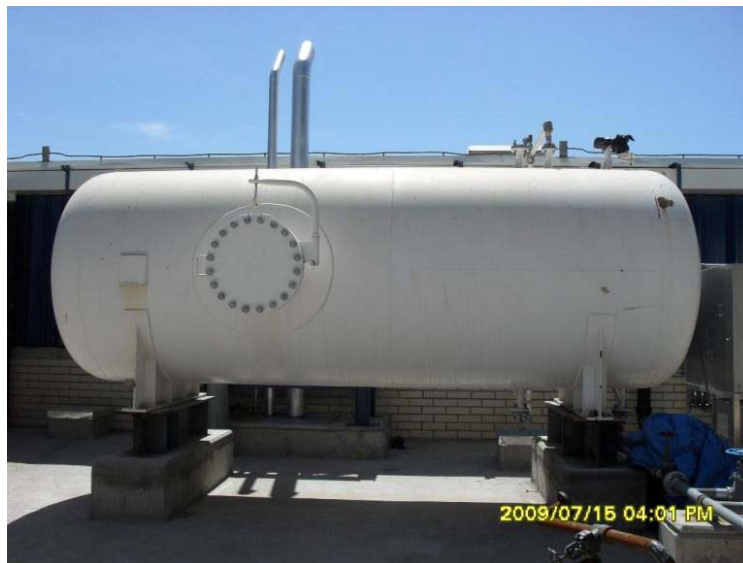
Fig. 1.2. Recipiente de almacenamiento agua potable.
