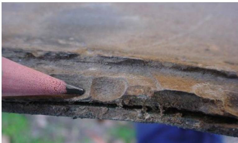
Figura 19.- Pérdida de metal del 87% en una vista macro en la zona de mayor abertura de labio.
